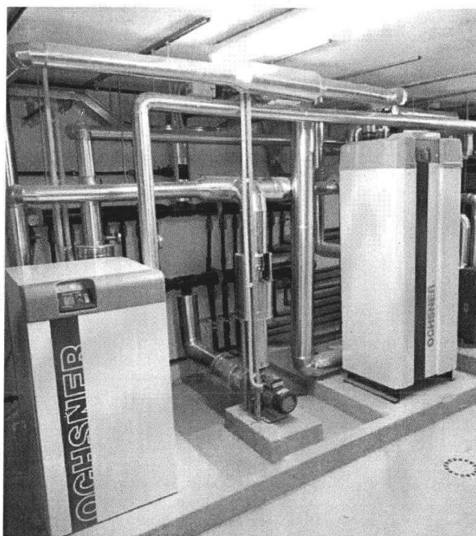
La geotermia nel residenziale. Impianto geotermico integrato con il fotovoltaico in un condominio a Follonica, dove vivono venti famiglie
